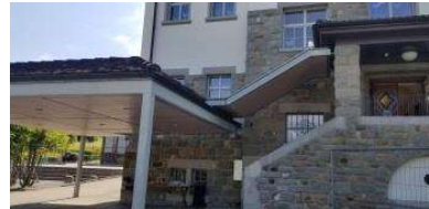
Blick auf das Vordach (links), von Westen her welches ersatzlos abgebrochen werden soll!
